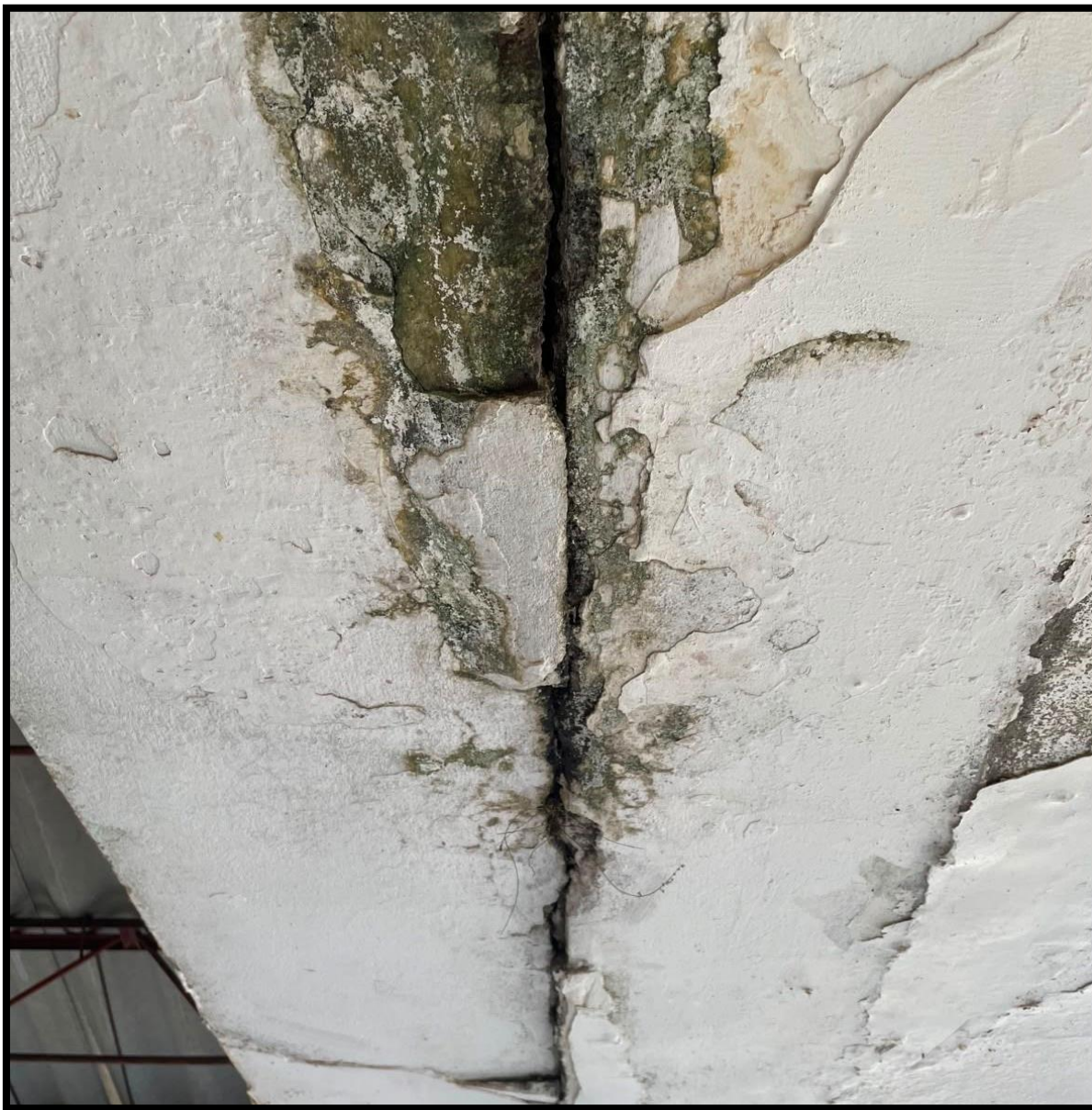
Fotografía 2. Fisura en junta de dilatación ubicada en vigas de losa.
