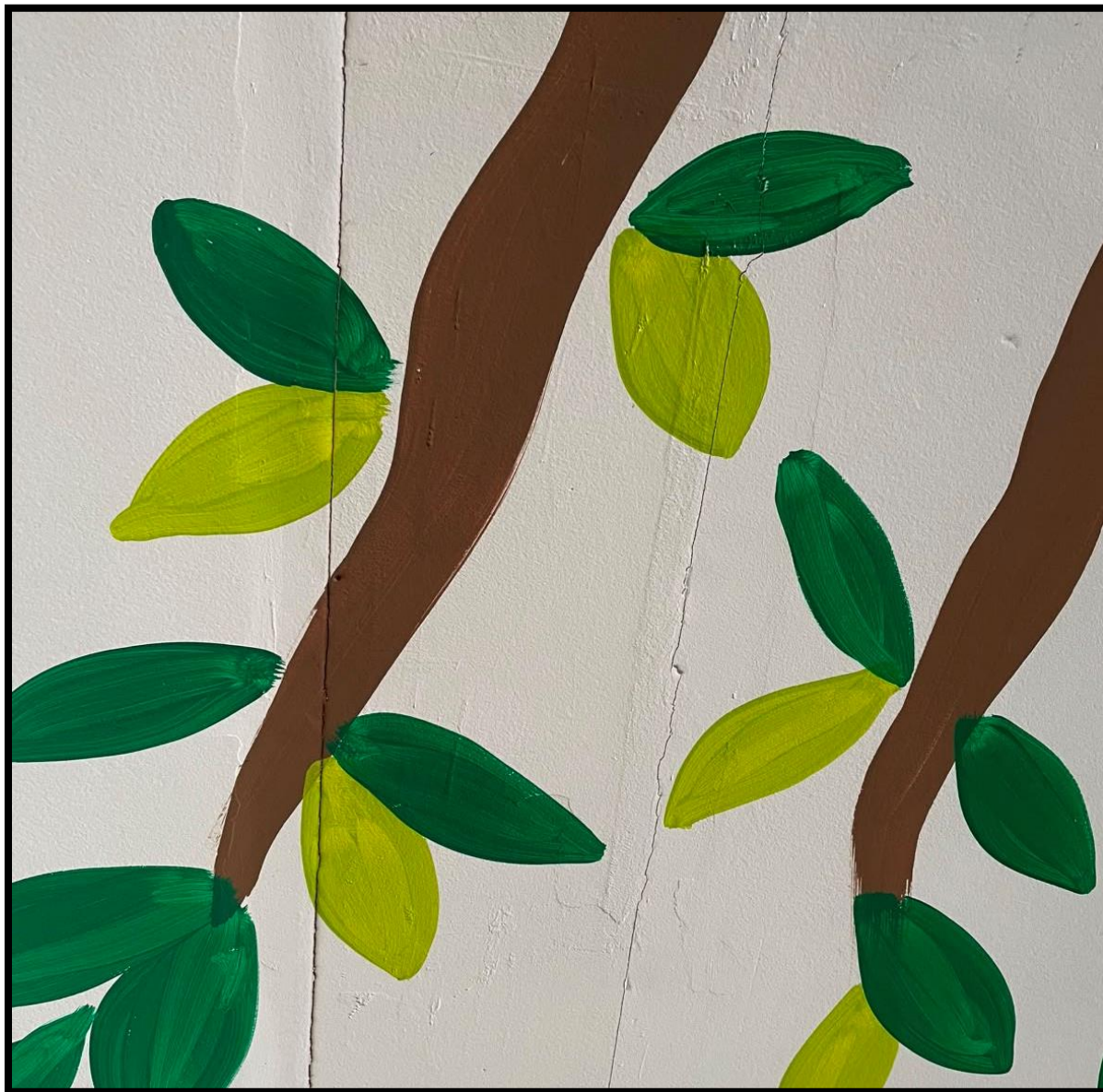
Fotografía 2. Dilatación en unión de láminas de panel yeso en cielo falso.
