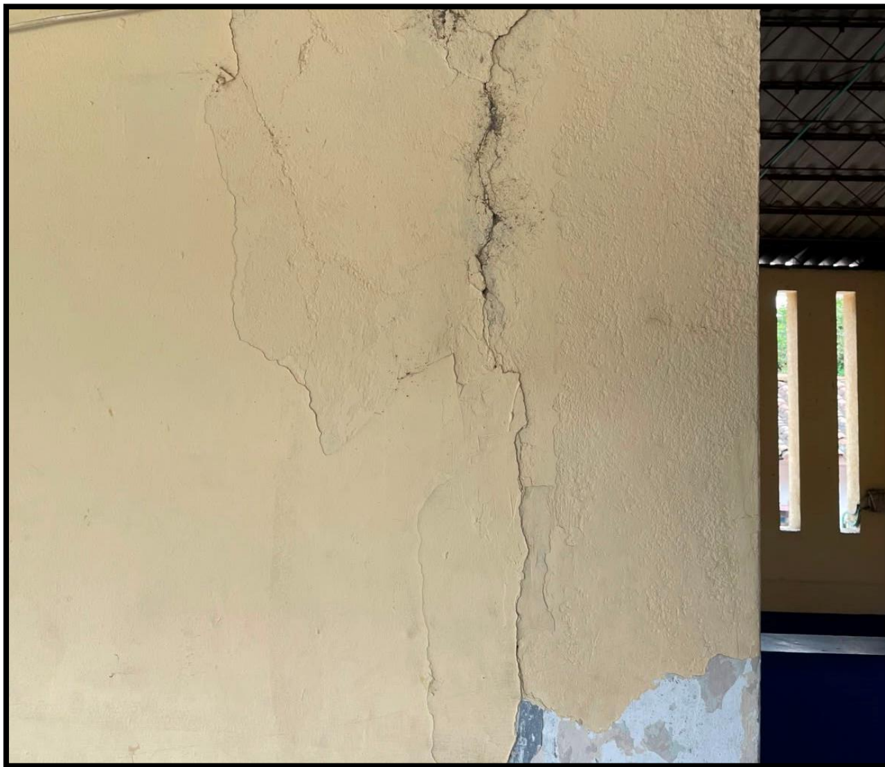
Fotografía 4. Fisuras superficiales en mampostería de muros divisorios.
