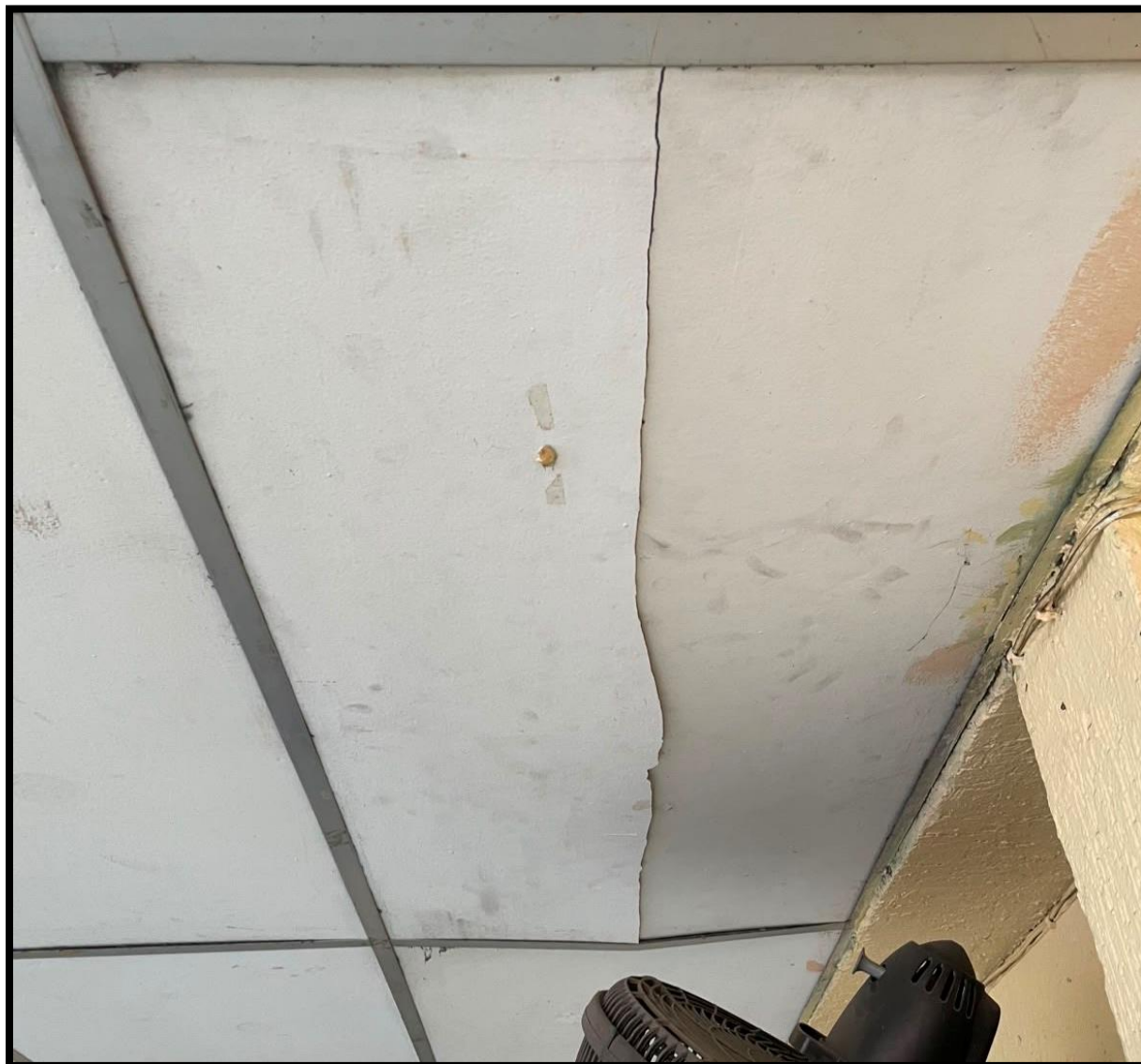
Fotografía 3. Ruptura de lámina de súper board en cielo falso.
