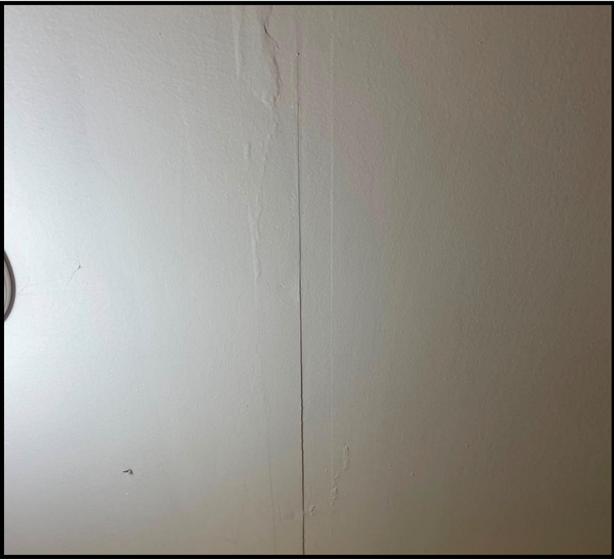
Fotografía 5. Dilatación en panel yeso de cielos.
